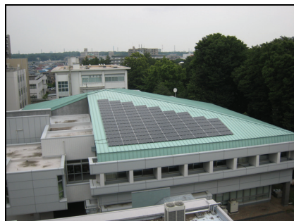
太陽光発電設備
