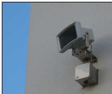
屋外放送設備
