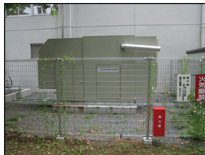
非常用発電設備
