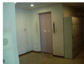
7棟エレベータ
