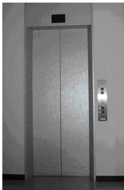
同棟エレベータ
