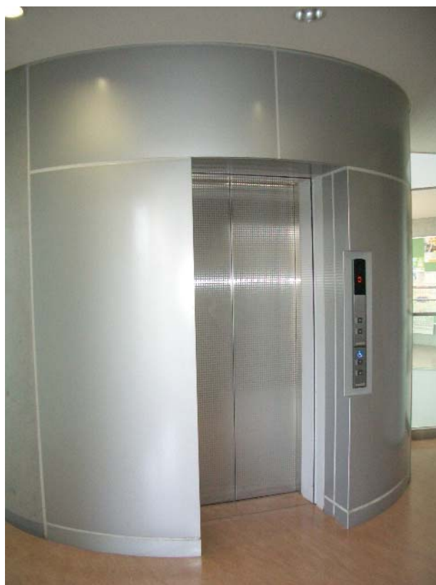
総合教育棟エレベータ
