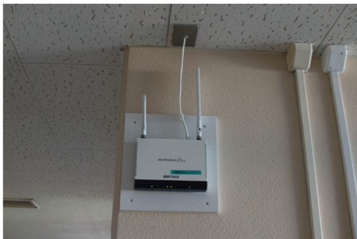
資料 3-2-B 校舎内廊下に設置された無線 LAN アクセスポイント
