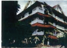
2006年5月26日インドネシアジャワ島中部地震によるRC4階建てオフィスビルの被害 (撮影:前田匡樹氏,東北大学)
