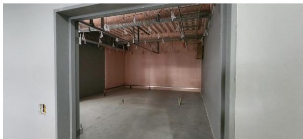
サーバー室の状況
