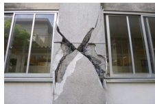
耐震化未完了の建物が 大規模地震で甚大な被害を受けた例
