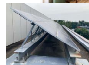
(左) 西1号館屋上太陽光パネル
