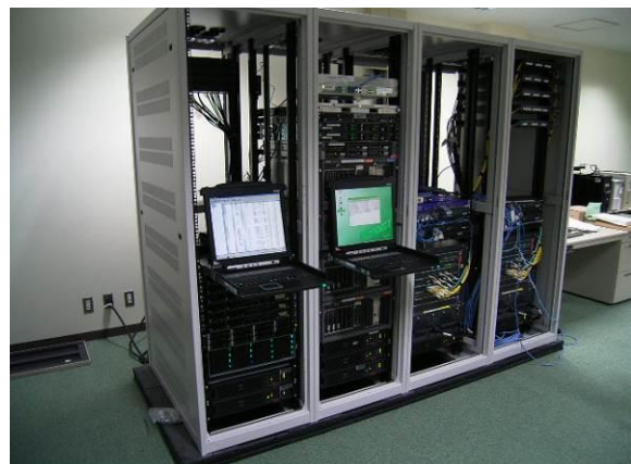
サーバールーム
