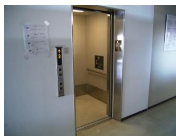
身障者用エレベータ (第2研究棟)
