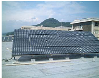
図1 本校の太陽光発電設備
